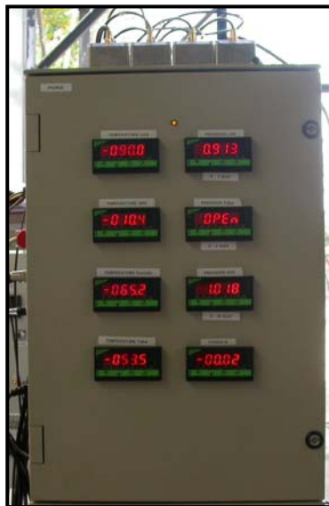
Figure 47. Afficheurs et relais des détecteurs de choc (en haut du boîtier de lecture)
