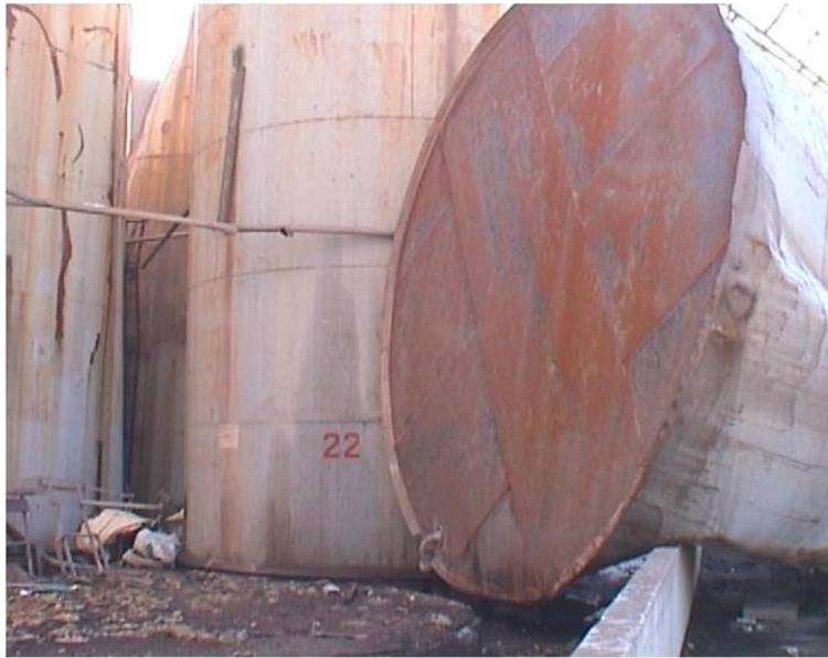
FIGURE 2.1 – Renversement d'un réservoir vide (AZF 2001).
