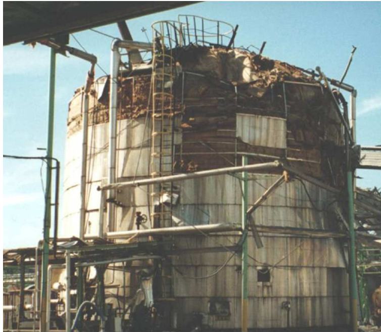
FIGURE 2.4 – Toit de réservoir enfoncé.
