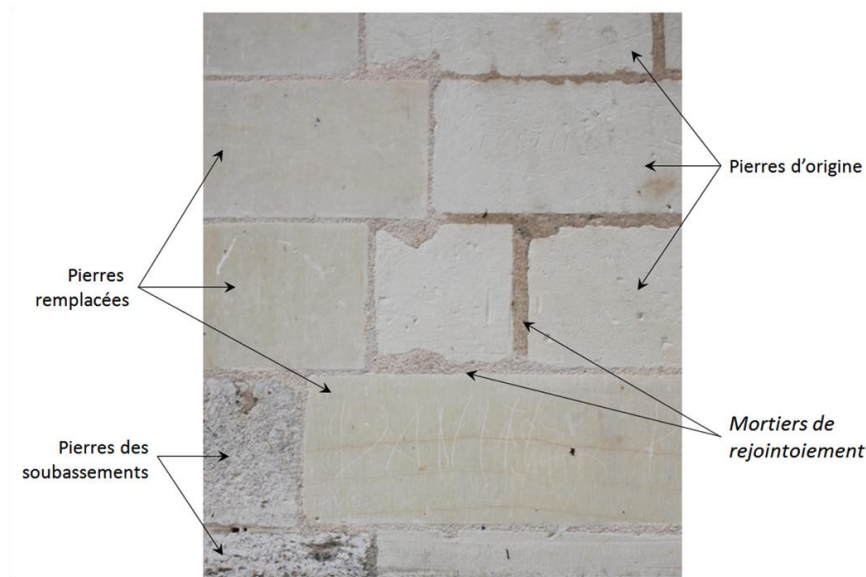
FIGURE 6 : EXEMPLE DE DIFFERENCE DE FACIES ENTRE PIERRES D'ORIGINE, PIERRES REMPLACEES ET PIERRES DES SOUBASSEMENTS, ET EXEMPLE DE JUXTAPOSITION DE MORTIERS DE REJOINTOIEMENT DIFFERENTS - AILE SUD
