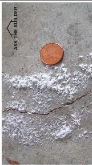
Fracture dans le ciment
