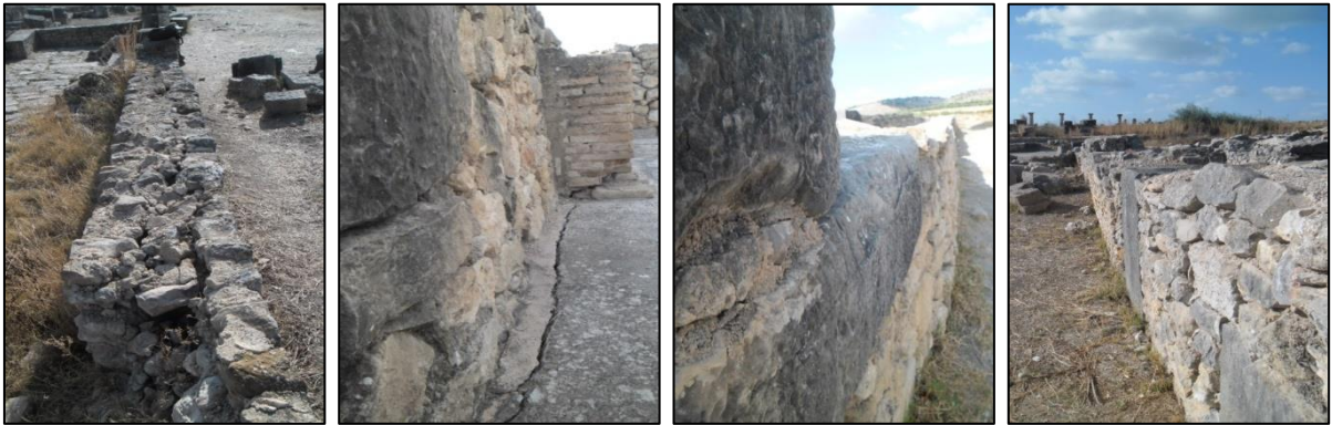
Figure III-5 Exemples de désordres structuraux : effondrement, fracture au pied de mur, bombement et inclinaison
