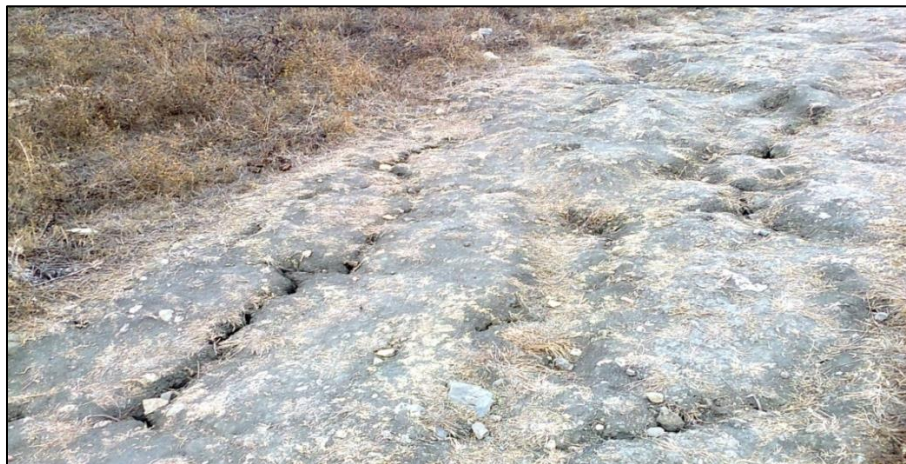
Figure I-5 Fissurations du sol probablement dues à un glissement vers oued Fertassa
