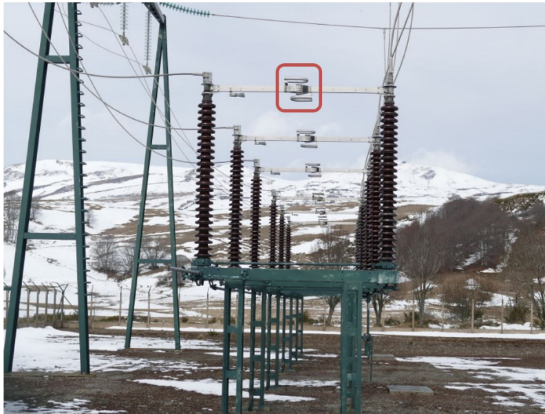
FIGURE 1.2 – Photographie du contact fermé dans chacun des six sectionneurs d'un poste de transformation (ligne de 90 kV pour les trois les plus en avant et de 63 kV pour les trois du fond). Le premier contact le plus en avant est encadré en rouge [3].
