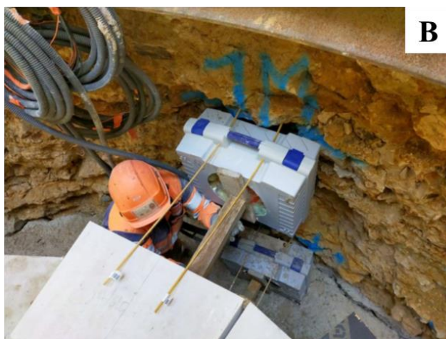
Figure 3.15 : Boucle SNMR dans la boîte PVC (A) côté ZNS avec la sonde température (cercle rouge) et (B) installée dans le puit avec une ouverture côté claveaux ouvertes pour permettre le remplissage par le fillaire. (Rapport BRGM RP-71648-FR)
